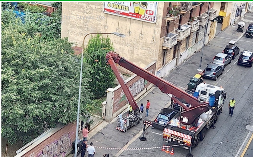
In via Genova, il 12 settembre scorso, un operaio è deceduto cadendo dal cestello di una gru
